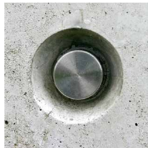
Retsbygningen i Holstebro fra 1992 af 3xN, hvor konushullerne er udfyldt med en metalprop. Foto: Tommy Bæk Hansen.
