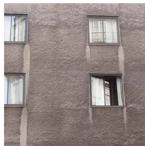
Tydelig afvaskning af overfladen i striber på Hotel Astoria i København, tegnet 1935 af Ole Falkentorp. Resultatet er en uensartet patinerings under vinduerne. Foto: HBN.
