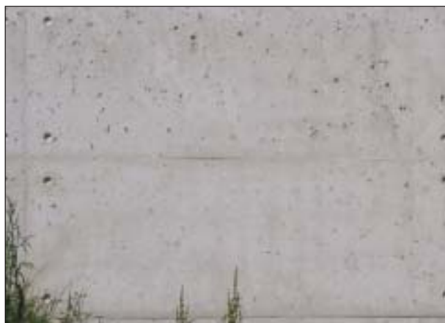
Uensartet vibrering har givet anledning til en tilsvarende uensartet fordeling af luftblærer i betonens overflade.
